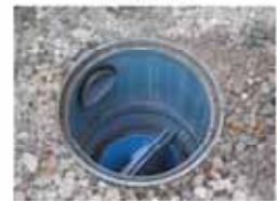
雨水浸透マス
